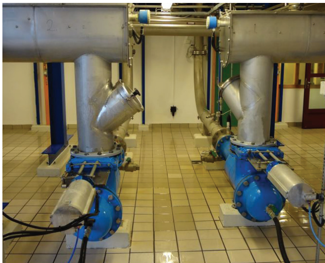
SK PUMPEINSTALLASJONER PÅ LARVIK RENSEANLEGG Installasjon med inspeksjonsluge i tilførselsrøret for inspeksjon og prøvetaking.
