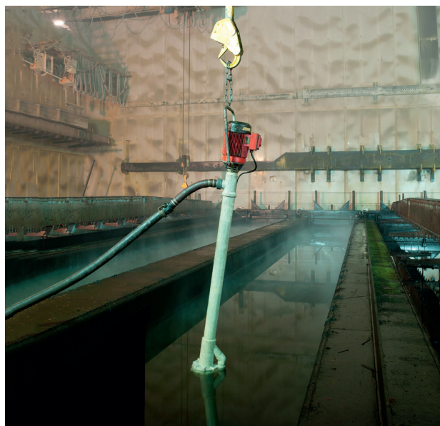
F 640 – Trasporto di acido cloridrico diluito da una vasca di decapaggio.
