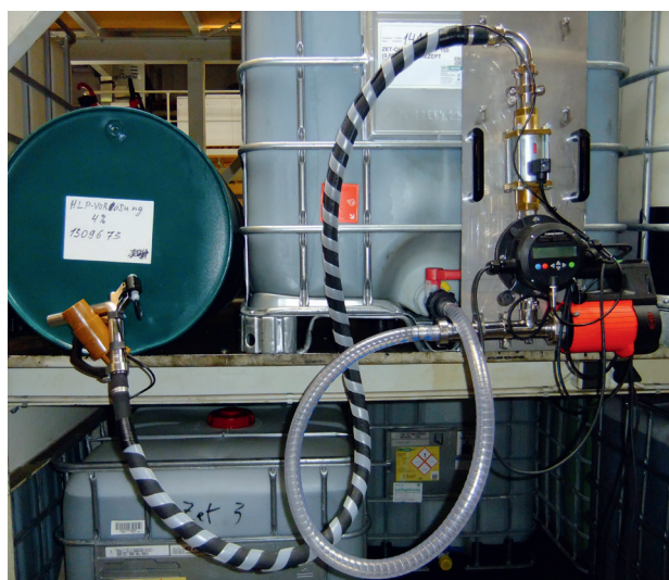
Settore: oli minerali, oli per la lavorazione dei metalli
